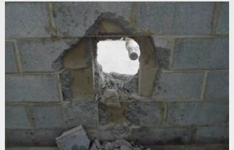
Muro de mampostería después de 87 impactos
